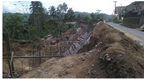
Gambar 1. Amblesan jalan raya yang berakibat bencana longsor pada ruas Jalan Ajibarang – Gumelar Kabupaten Banyumas pada tahun 2017 ( https://radarbanyumas.co.id/ )
