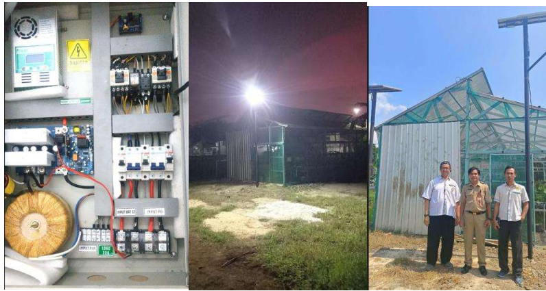
Gambar 1. Dokumentasi Panel Kontrol Dan Green House
