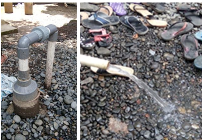
Gambar 9. Instalasi pompa air tanam dan air yang mengalir dari sumur di kompleks Masjid Al-Jihad, Desa Metenggeng, Kecamatan Bojongsari.
